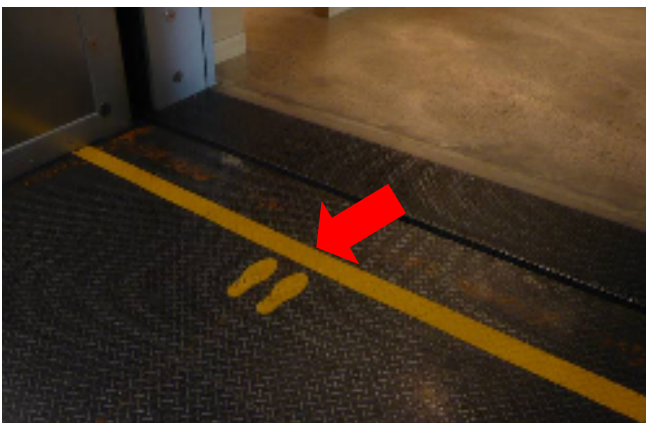
エレベータ安全ライン
